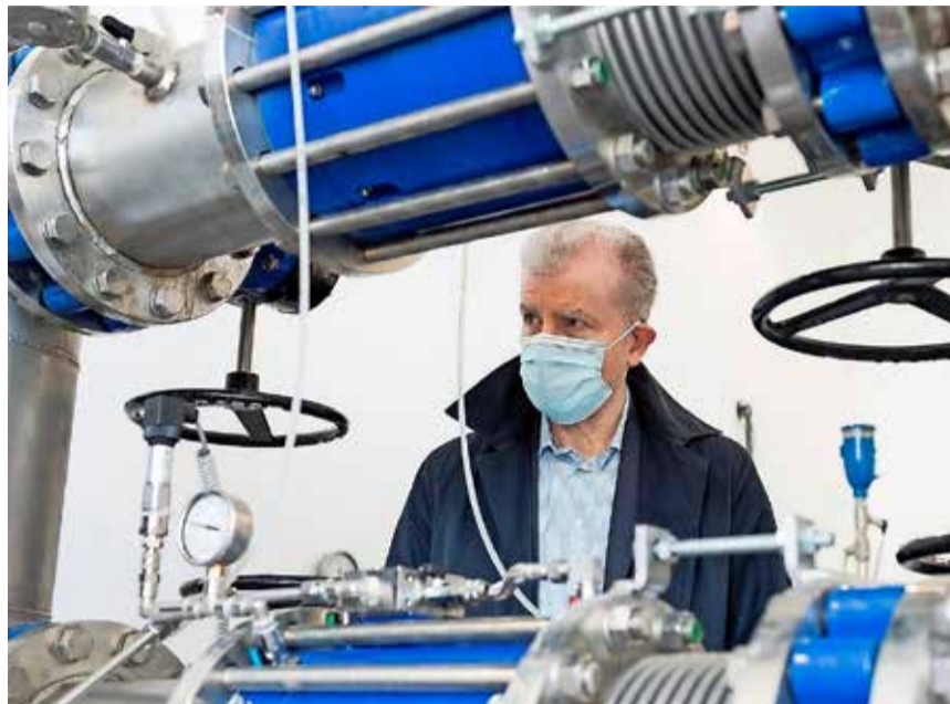
Marco Alberti, Verkaufsleiter bei GF Piping Systems Italien, überprüft doppelte Druckregelventile zur Steuerung der nachgeschalteten Druckregulierung. BILD ZVG/GF
